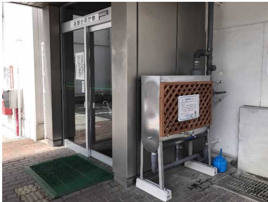
【長野合同庁舎に設置】
