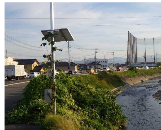
【 簡易型河川監視カメラ 】
