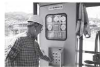
■宮沢川樋門(秋津地区) 今回、消防団や区などが管理している19カ所の樋門でも訓練を行いました。対策本部からの電話での指示により、実際に樋門を閉じ、作業状況の把握と連絡体制を確認しました。
