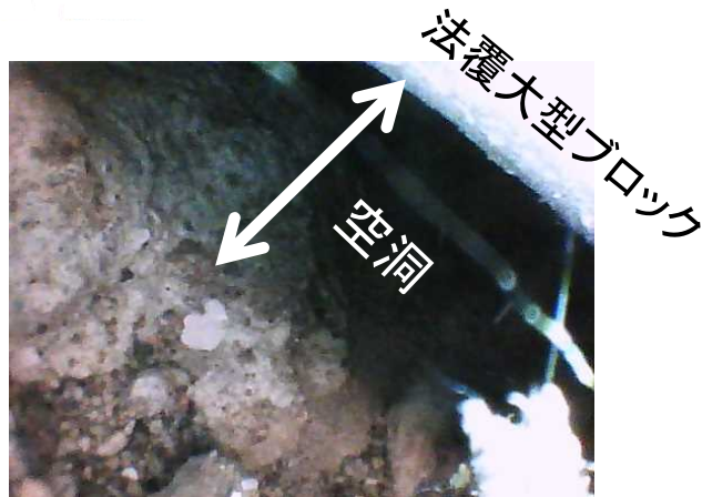
法覆大型ブロック背面空洞
