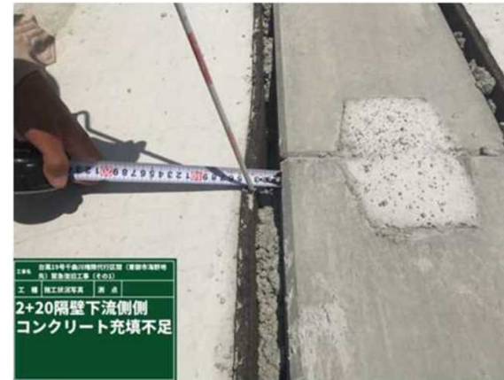
目地施工不良
