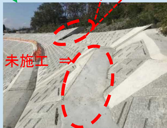
法留基礎未施工 (上流側)
